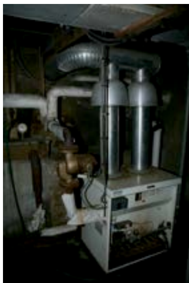
Afb. 28. Kelder met cv met buis door buitengevel. Foto: Auteur.
