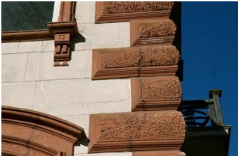
Afb. 42. Overgang van rustica-stukwerk waarbij de bovenste drie uit 1914 dateren en net iets grover zijn uitgevoerd dan de onderste twee. Foto: Auteur.
