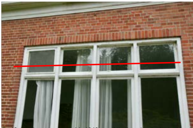
Afb. 43. Kozijn aangepast vóór 1949 waarbij alleen het gedeelte boven de rode lijn is vernieuwd. Daaronder is dit nog origineel. Foto: Auteur.
